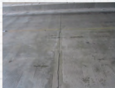
隧道路面横向裂缝
