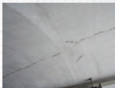
隧道纵向裂缝
