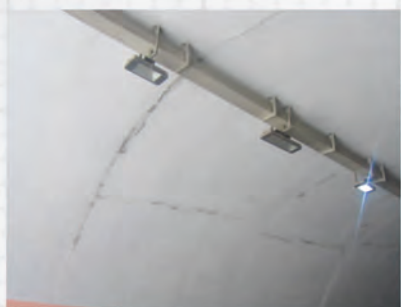
隧道纵向及环向裂缝
