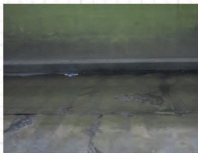
路面开裂及破损
