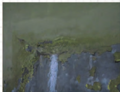
隧道衬砌渗水腐蚀
