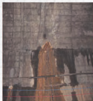
仰拱或 侧边墙渗水
