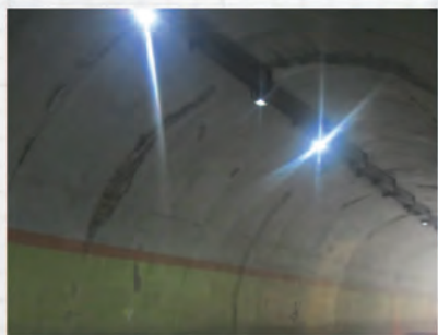
隧道衬砌渗水腐蚀
