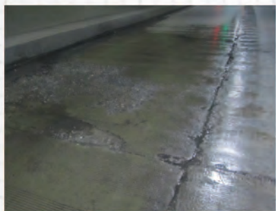
隧道路面破损，开裂
