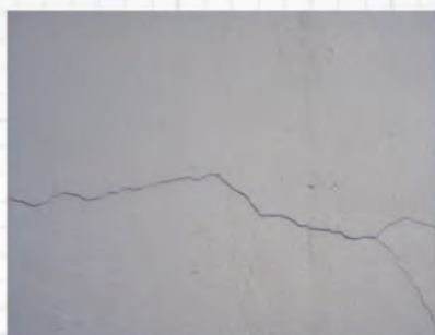
隧道网状裂缝
