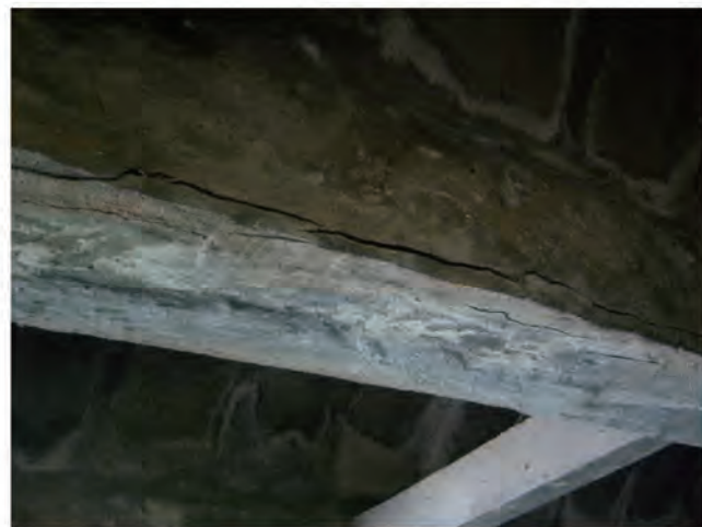
南京长江大桥引桥双曲拱桥拱肋混凝土剥落
