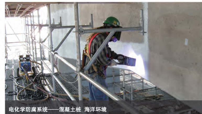
电化学防腐系统——混凝土桩 海洋环境
