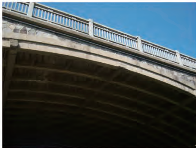
引桥双曲拱桥拱肋钢筋锈蚀、露筋
